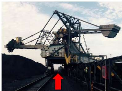
Foto 4. Identificación de la zona debajo del anillo central de los apiladores/reclamadores. En operación no se debe parquear equipo liviano debajo del área del anillo central de los apiladores/reclamadores
